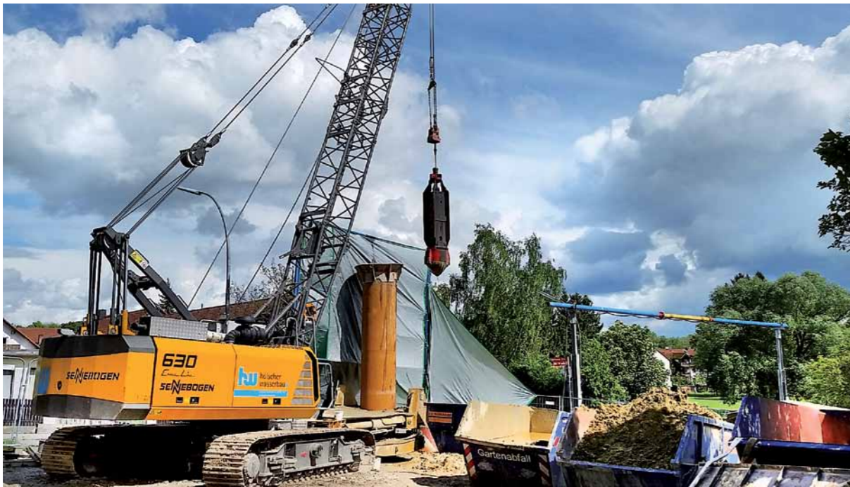
Kräne und andere Großgeräte kommen beim Pumpversuch für den Bau der Westtangente in Vötting zum Einsatz. Bild: Stadt Freising
