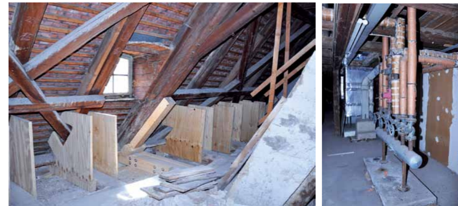
Statische Notsicherung des Dachwerks (links), veraltete Heizungsinstallation (rechts): Das Asamgebäude muss dringend saniert werden.
